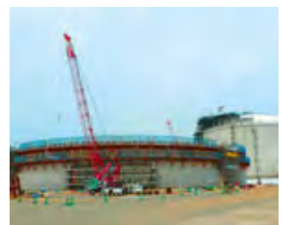
Hokkaido Gas, Ishikari LNG Terminal
