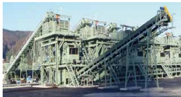
除塩設備（岩手県大船渡市）
