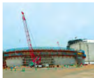
北海道ガス石狩LNG基地
