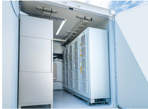
▲ 蓄電池システム内のインバータ (DC/AC変換装置)
