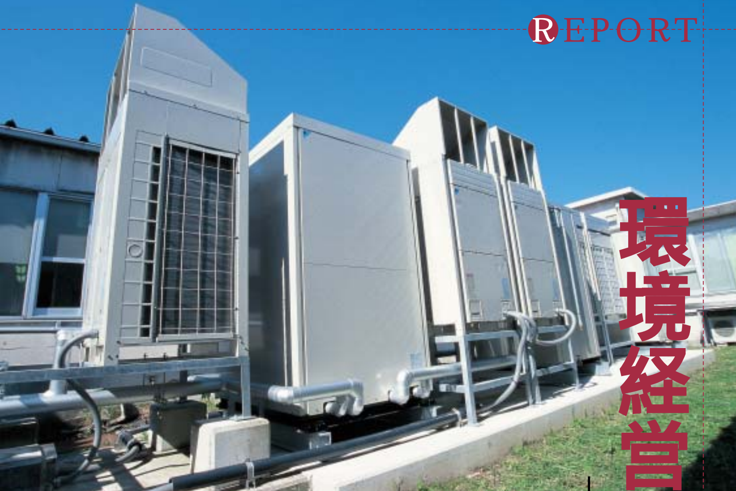
今回のタカギセイコーへの融資対象となった氷蓄熱式冷房装置の室外機。低料金の夜間電力を使って氷を製造し、日中の工場を冷房する。
