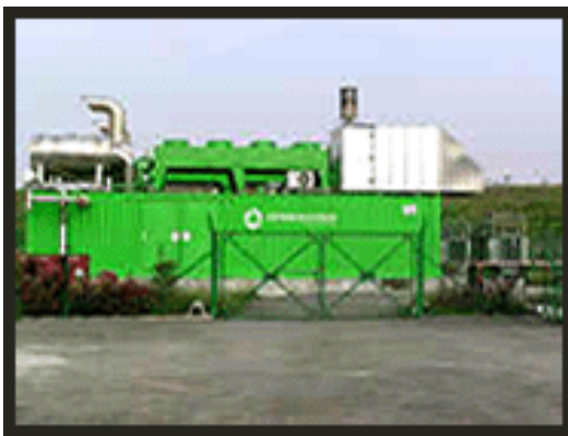
ガスエンジン建屋
