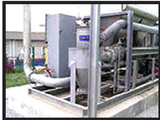
バイオガス抽出システム
