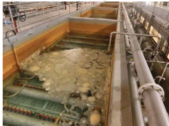
【限界ろ過膜を利用した浄水施設】
