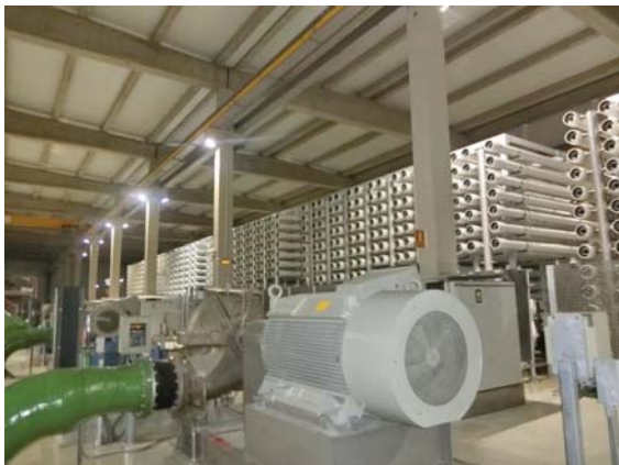
【逆浸透膜を利用した浄水施設】
