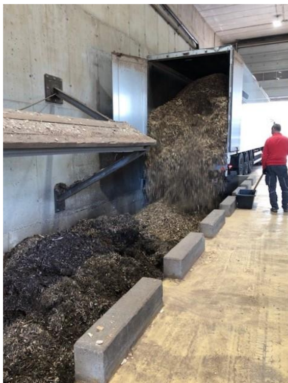
写真3-2 地域熱供給施設に搬入される低質チップ
