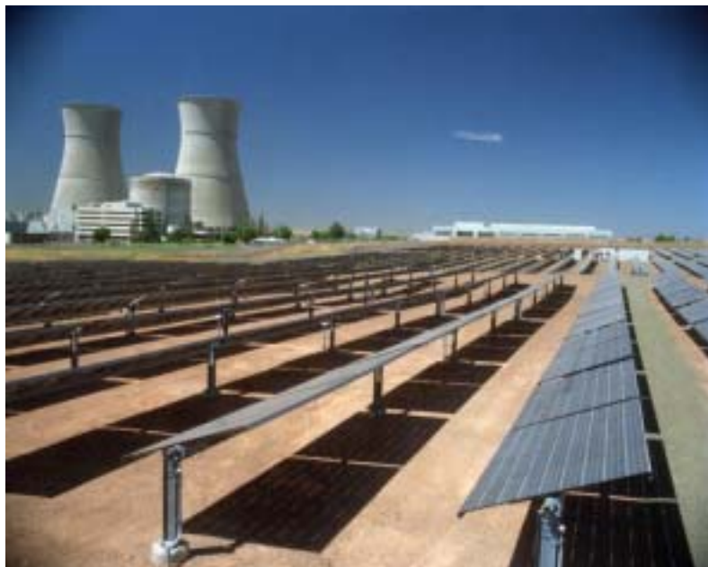
原子力発電所に併設する太陽光発電施設(出力 2MW) Sacramento
