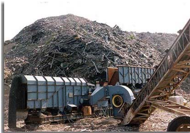
除去前の瓦礫の山
