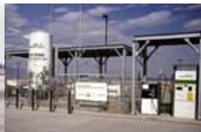
図3-4 米国の水素ガスステーション
